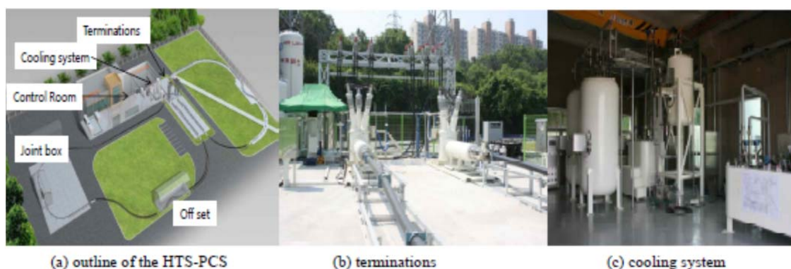
図 4-5 韓国電力利川変電所 HTS ケーブルシステム （韓国電力 Yang 氏提供）
