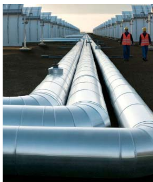
図 5 Siemens 社太陽熱プラントの熱媒配管 5)
