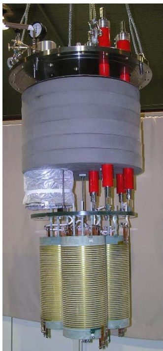
組み立て終了後の三相限流コイル
