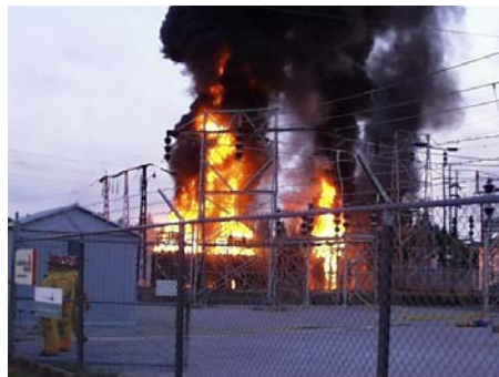
図5 従来型変圧器の火災事故 (アメリカ1999年)
