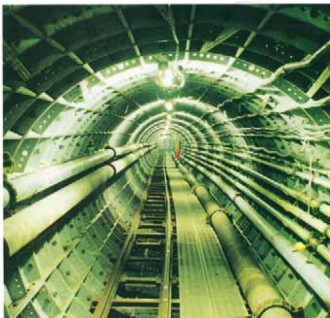
図1 送電ケーブル用洞道
