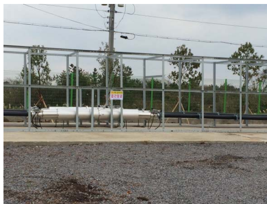
右：超電導 DC ケーブルとその接続部
