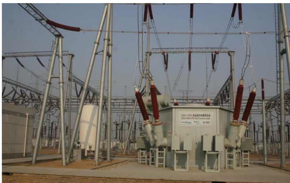
図4 天津の石各荘変電所の 220kV/800A 超電導限流器
