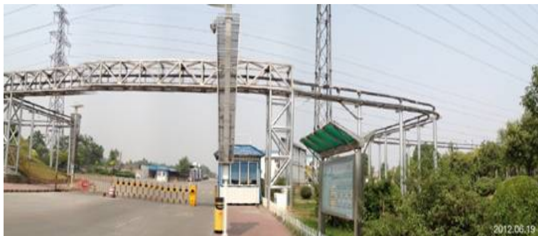
図3 敷設後の 10 kA 高温超電導直流ケーブル全景 (訳注: 写真中央水平部ライン)
