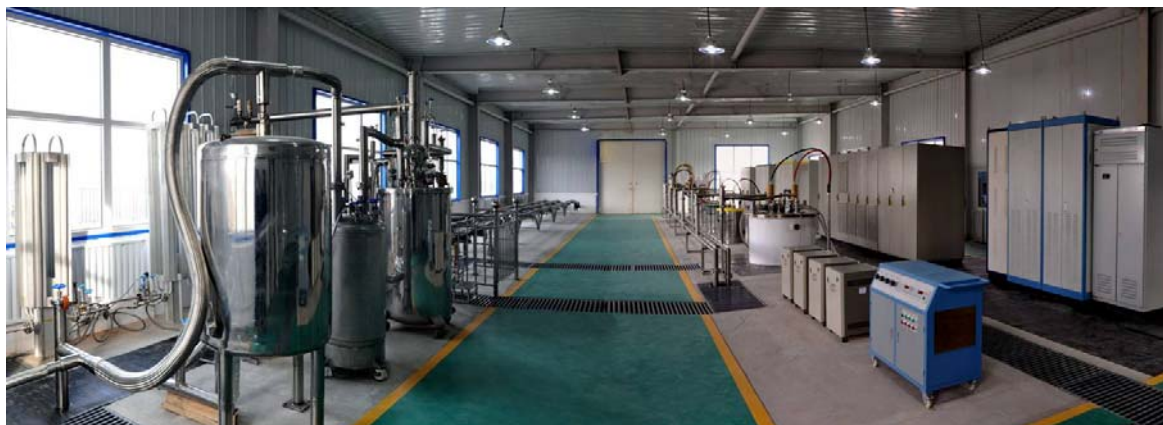
図2 超電導変電所の様子
