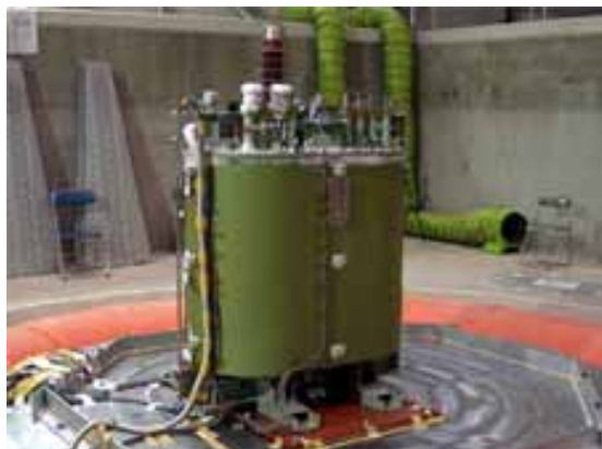
図1 実規模の床上配置超電導主変圧器
