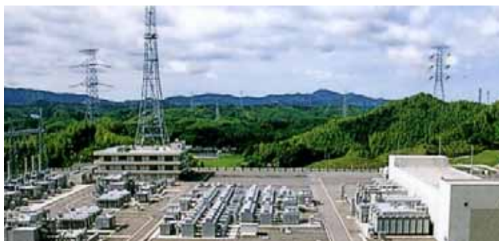
阿南交直変換所(四国電力資料より)
