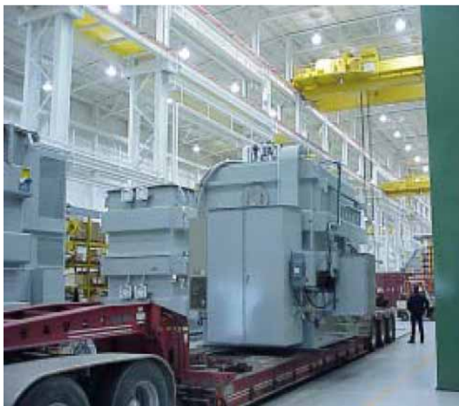
図1 WES社で試作された3φ24.9kV/4.2kV-5/10MVA器。鉄製のタンクに収納されている。
